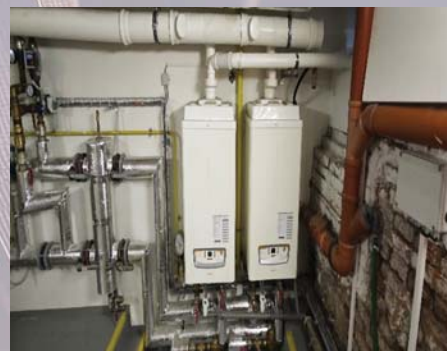
Plynová kotelna Azylového domu pro matky s dětmi, ul. 9. května, Přerov
