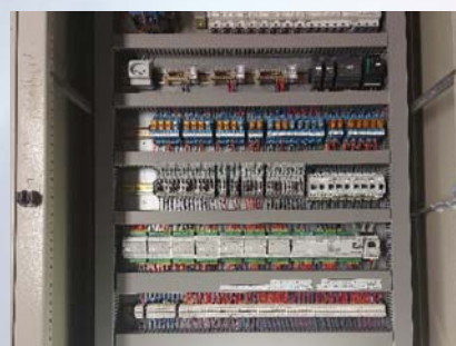
VST Bazén – nový rozvaděč elektro
