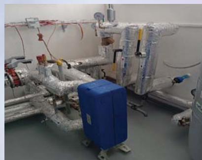
Objektová předávací stanice – Domov Alzheimer, Přerov
