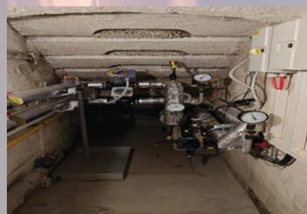
Horkovodní výměňková stanice Jateční 1746/22, Přerov
